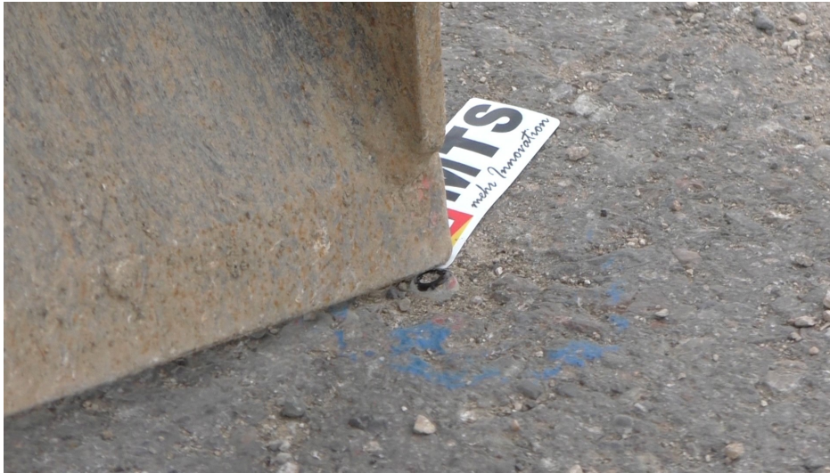
Abb.: 9: Nach dem Einmessen des Schwenklöffels müssen sie grundsätzlich einen bekannten Festpunkt auf der Baustelle anfahren um die Kalibrierung anhand der bekannten Koordinaten/Höhe des Festpunkts zu überprüfen.
